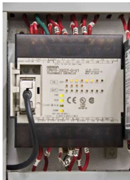
L'ensacheuse horizontale Arty H75 est équipée de contrôleurs Omron.
